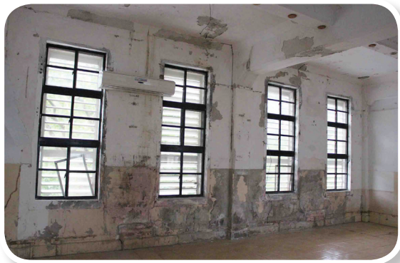
牆面粉刷層受白蟻侵入。
