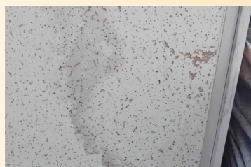
天花板的滲漏水。
