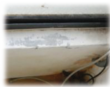
圖書室牆壁壁癌嚴重。
